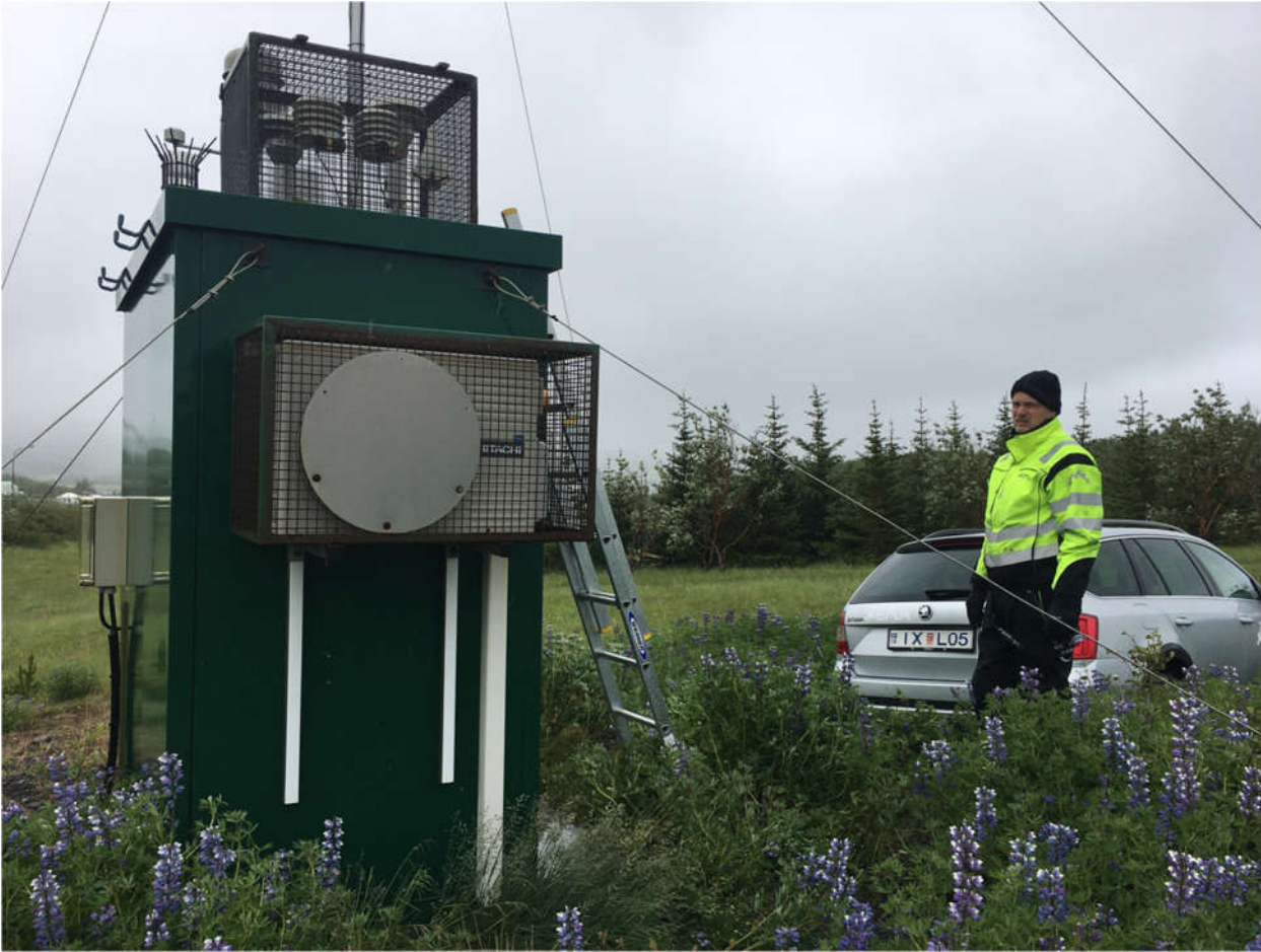
Mynd 1. Mælihus PCC við Bakka á Húsavík. Hér má sjá sambærilegt hús. Húsin á Suðurnesjum verða þó ekki stöguð eins og húsið á þessari mynd.
